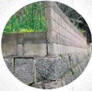
擁壁上のブロック塀 の危険性
