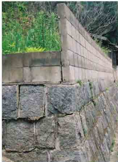
石造の擁壁の直上に基礎なしで設けられた塀。地震により上部が傾き危険な状態である
