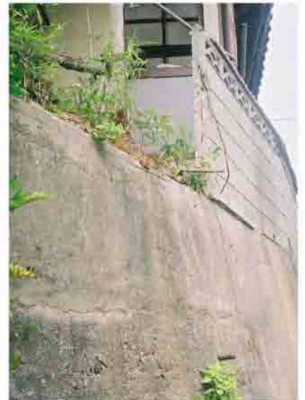
下部の擁壁と一体となるよう施工されず、落下したブロック塀
