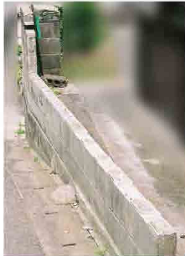
たて筋等が施工されておらず、粘ることなく倒れた塀
