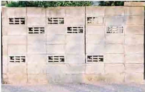
たて筋・よこ筋が施工されないと、継ぎ目がひび割れるなど危険な状態となる
